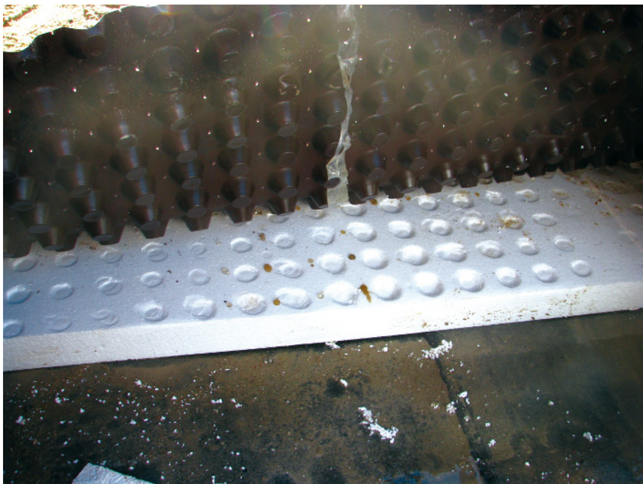
Fot. 7. Termoizolacja uszkodzona przez drenaż
