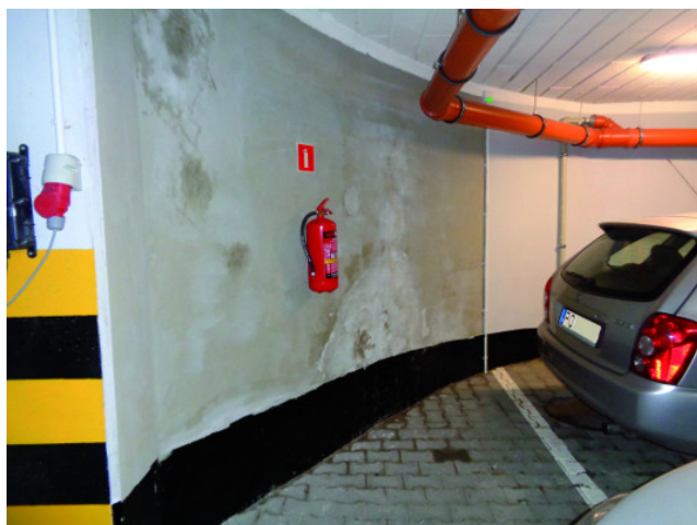
Fot. 1. Zawilgocenie ściany wynikające z braku prawidłowej izolacji (fot. archiwum autorów)
