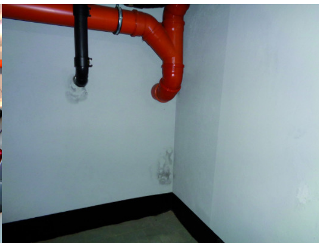
Fot. 2. Przecieki punktowe na skutek nieprawidłowego zabezpieczenia miejsc przebieg instalacyjnych (fot. archiwum autorów)
