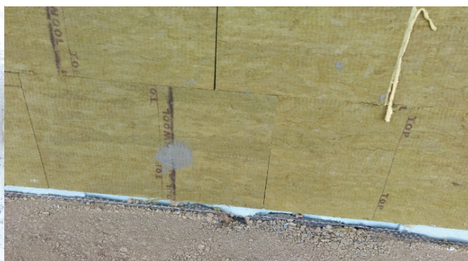
Fot. 4. Nieprawidłowe wypełnienie szczelin między wełną mineralną za pomocą pianki poliuretanowej
