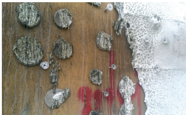
Fot. 3. Nieprawidłowe klejenie styropianu uszkodzonego wskutek pożaru
