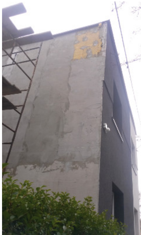
Fot. 5. Brak zastosowania siatki w warstwie zbrojonej
