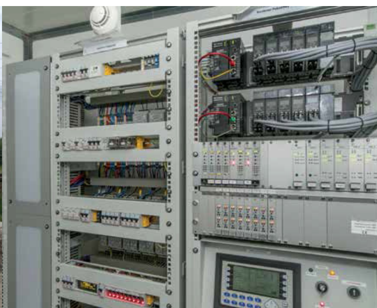
Fot. 3. Przykładowe wnętrze kontenera systemu ssp (RASP-4F)
