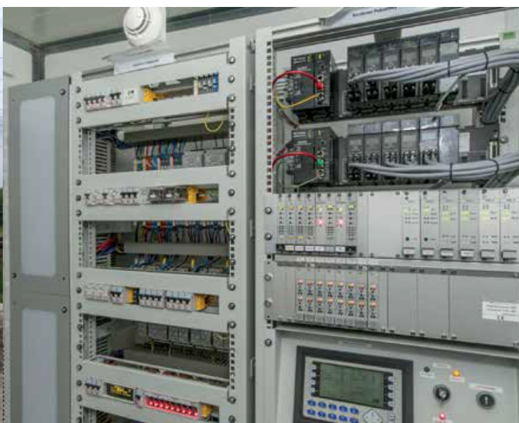
Fot. 3. Przykładowe wnętrze kontenera systemu ssp (RASP-4F)
