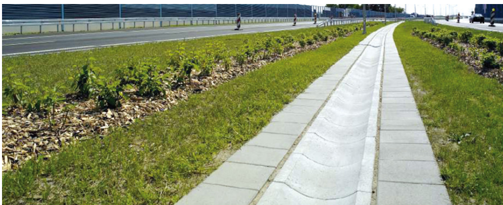
Fot. 3. Ściek korytkowy jako element odwodnienia pasa dzielącego
