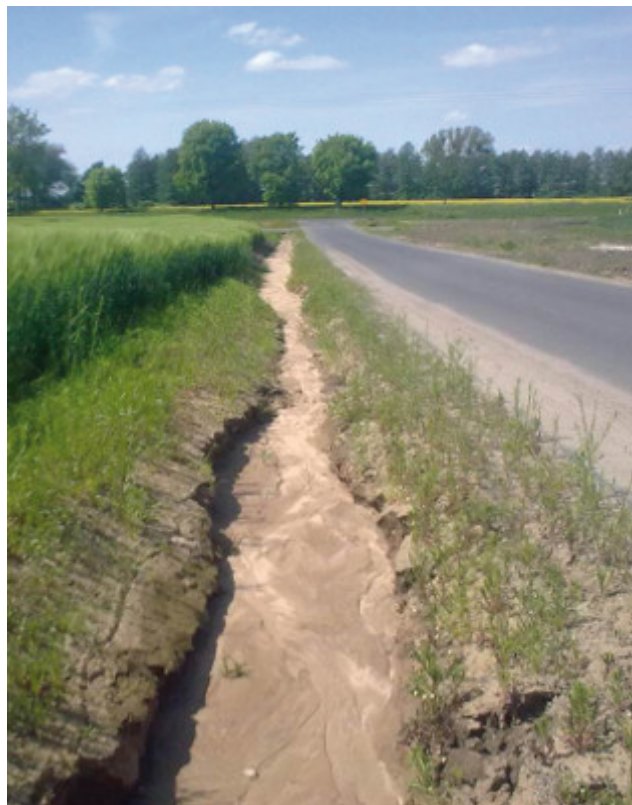
Fot. 4. Uszkodzenia dna rowu przez opady
