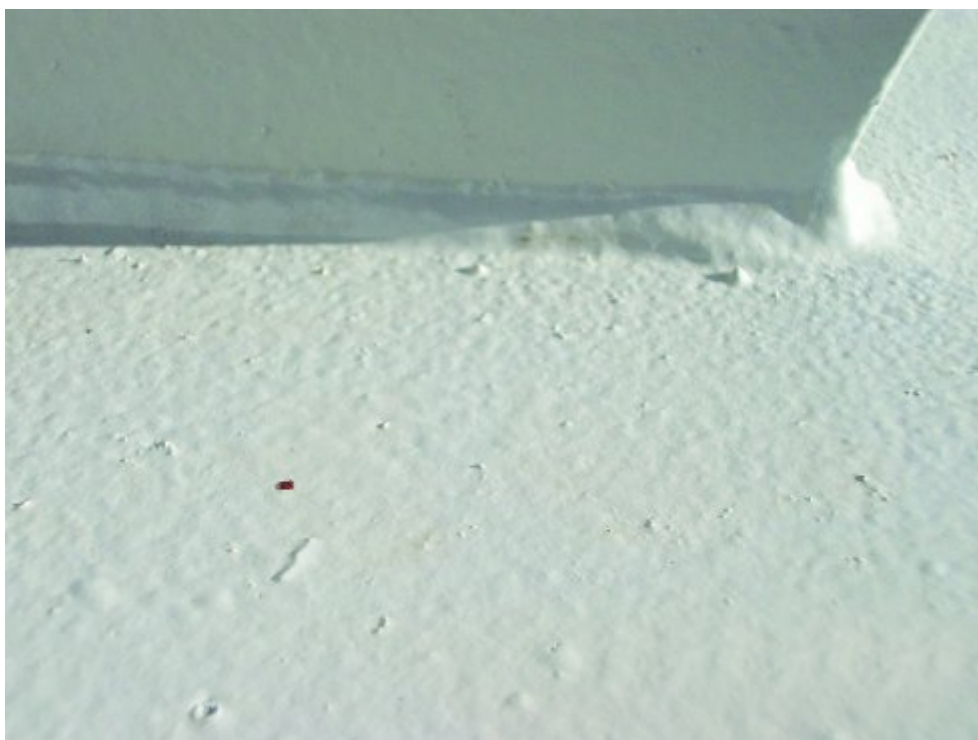
Fot. 6. Powłoki malarskie na bardzo nierównej powłoce metalizacyjnej
