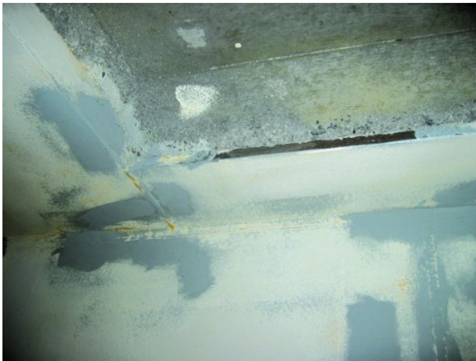
Fot. 7. Delaminacja powłoki metalizacyjnej na żle przygotowanej krawędzi ciętej na gorąco
