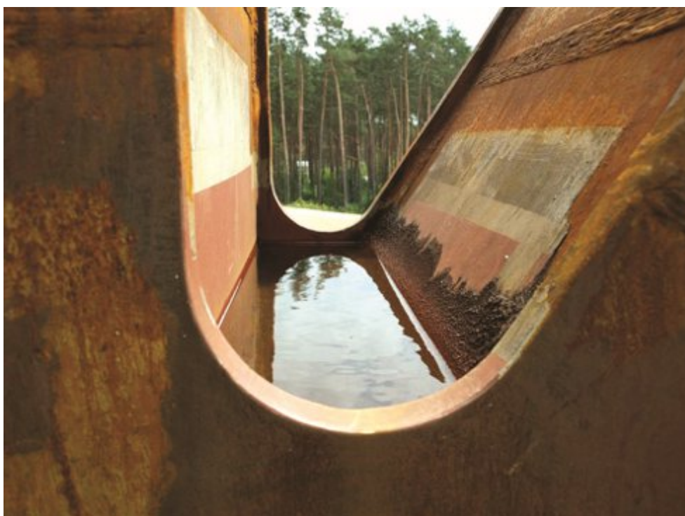
Fot. 4. Niewłaściwe rozwiązanie konstrukcyjne pozwalające na gromadzenie się wody na moście kolejowym
