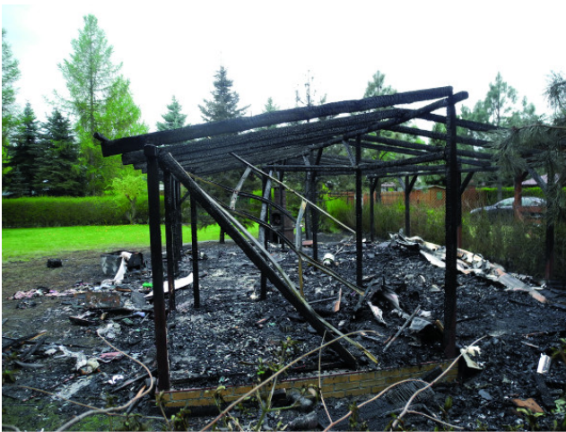
Fot. 1. Opalona drewniana konstrukcja nośna domu letniskowego po pożarze. Autor: archiwum ITB
