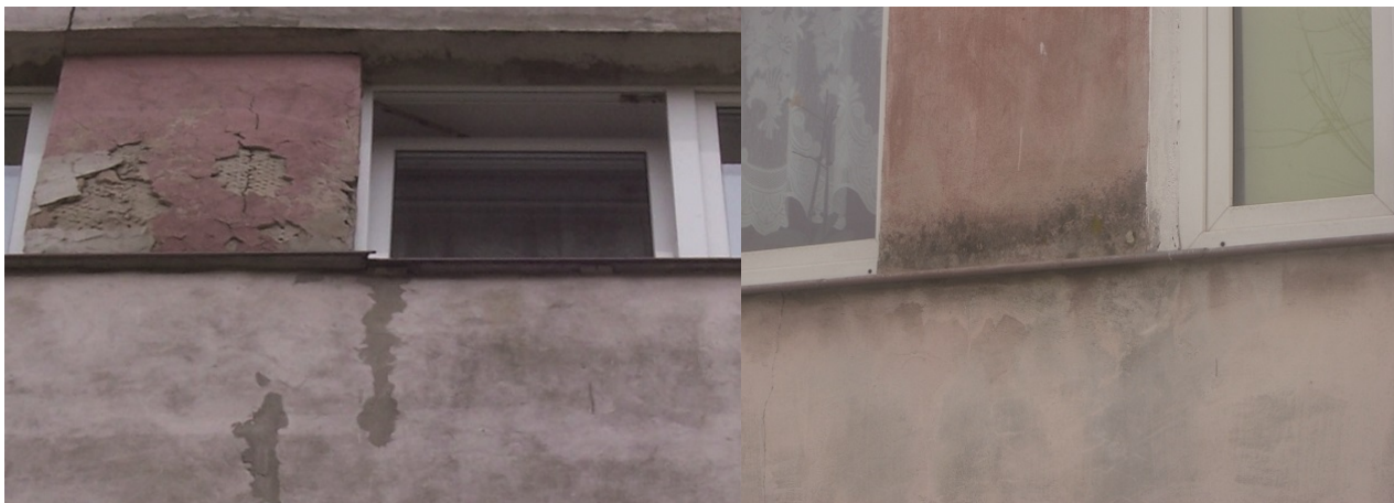
Fot. 3. Rysy i ubytki w warstwie tynku zewnętrznego
