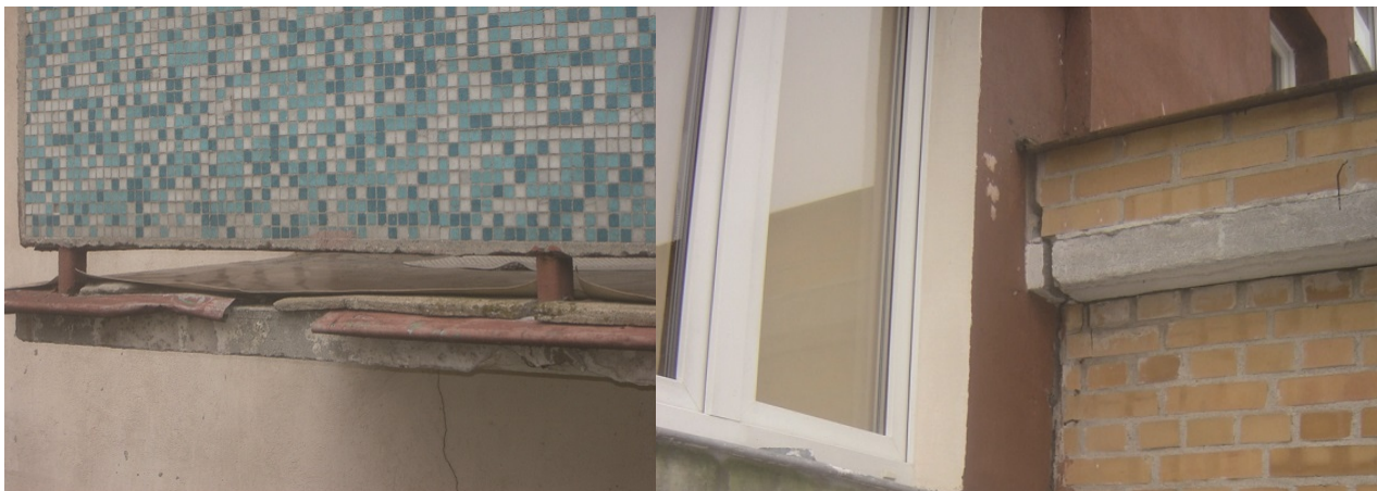
Fot. 5. Uszkodzenia balkonów [5]
