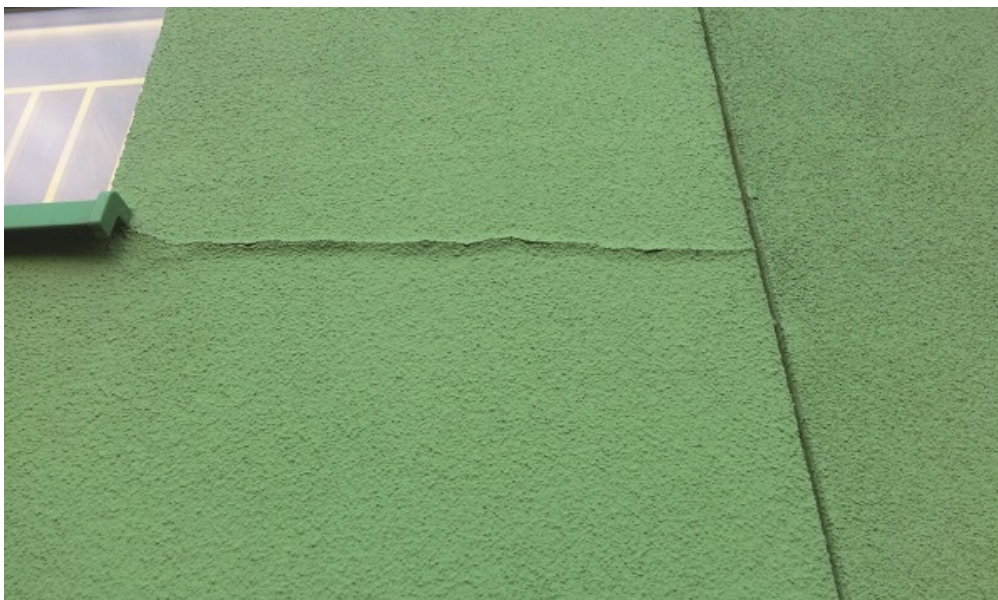
Fot. 4. Rysy na ścianie
