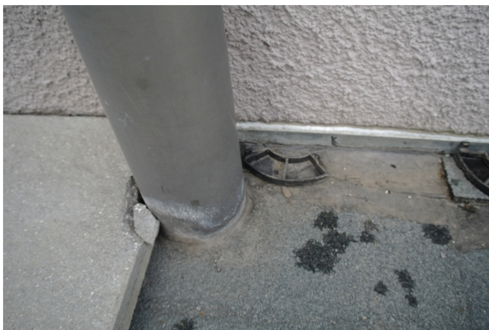
Fot. 3. Brak uszczelnienia przebicia izolacji balkonu przez rurę spustową
