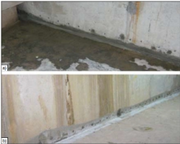
Fot. 6. Uszczelnienie ściany betonowej metodą iniekcji wysokociśnieniowej: a) założone iniektory i uszczelniona powierzchnia rakowata, b) osuszona ściana
