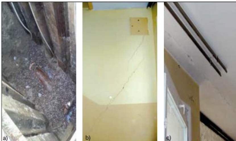
Fot. 3. Popękana ściana od wstrząsów i wibracji wywołanych przez zabijanie grodziec stalowych zabezpieczających głębokie wykopy w trakcie robót drogowo-instalacyjnych: a) głęboki wykop, b) popękana ściana, c) pęknięty strop
