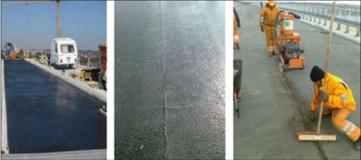
Fot. 4. Problemy występujące na obiekcie z mostowym o płycie betonowej z zastosowaniem asfaltu lanego [1]
