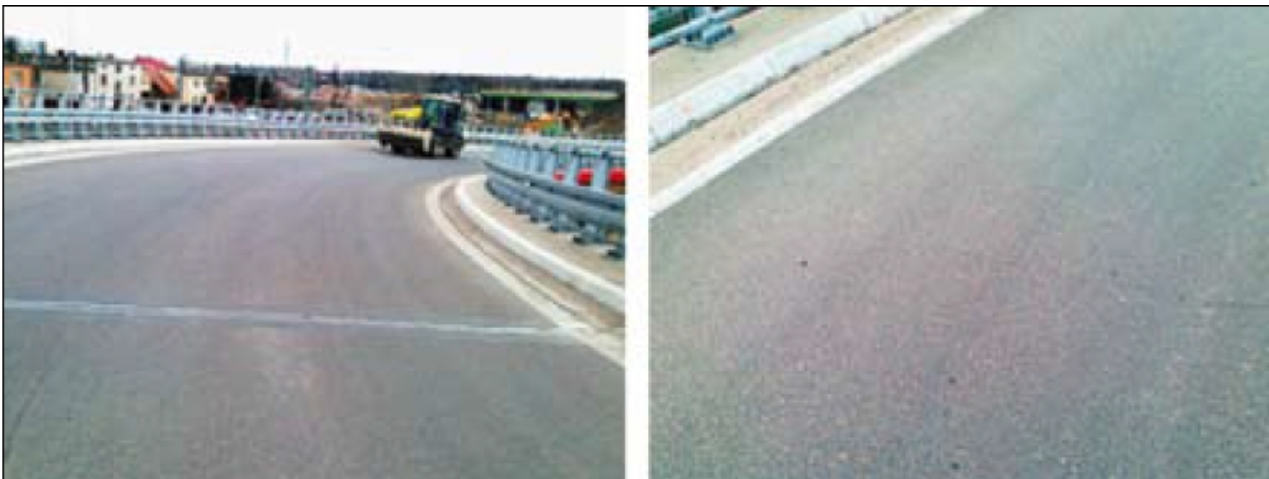
Fot. 5. Pęknięcia na warstwie ścieralnej (SMA 11), przeniesione ze szwów technologicznych warstwy asfaltu lanego MA 11
