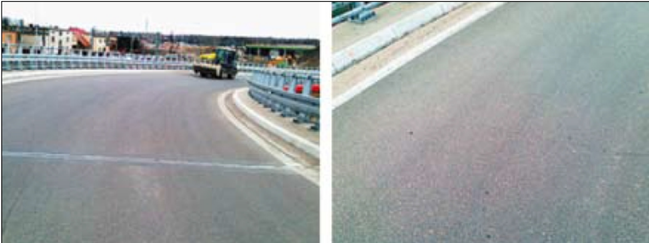
Fot. 5. Pęknięcia na warstwie ścieralnej (SMA 11), przeniesione ze szwów technologicznych warstwy asfaltu lanego MA 11
