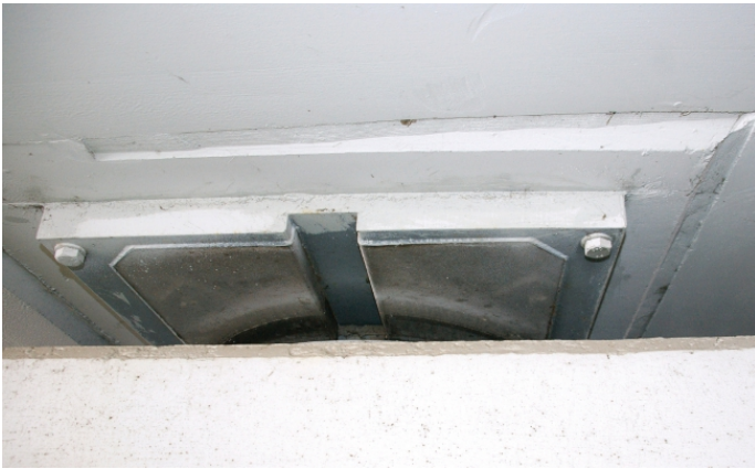
Fot. 2. Widok kanału przewodnicy w łożysku jednokierunkowo przesunym
