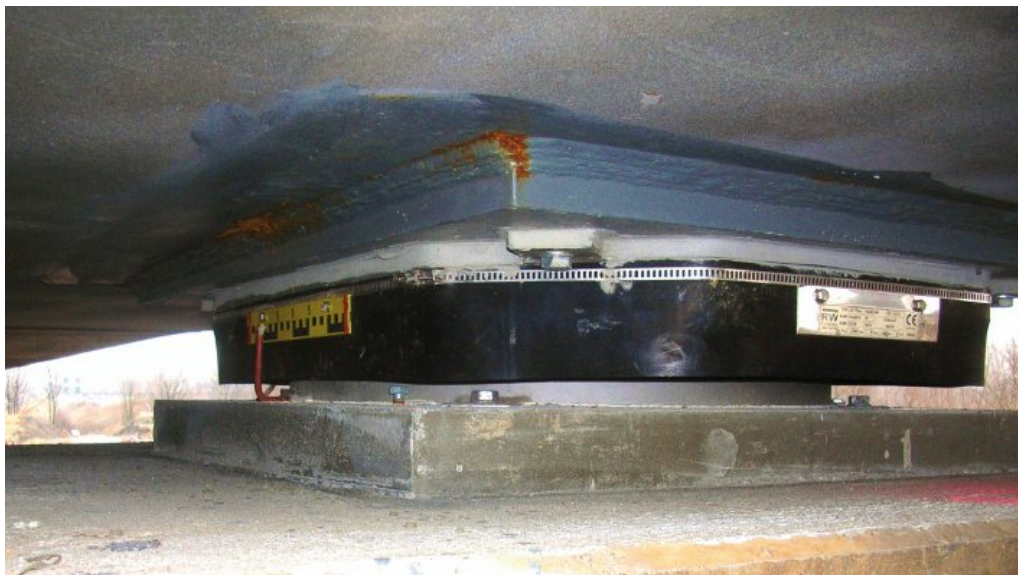
Fot. 1. Przykład prawidłowo zabezpieczonego łożyska garnkowego
