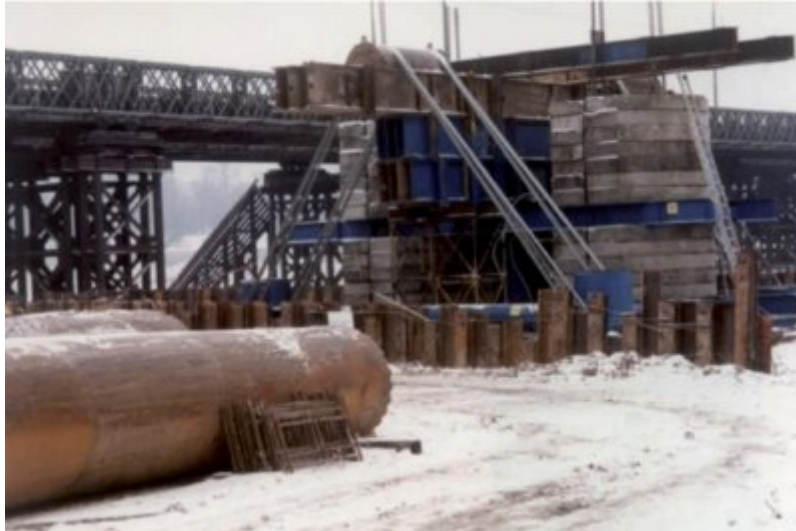
Fot. 1. Konstrukcja jednego z największych w Polsce próbnych obciążeń o sile ok. 14 000 kN na budowie mostu Świętokrzyskiego w Warszawie
