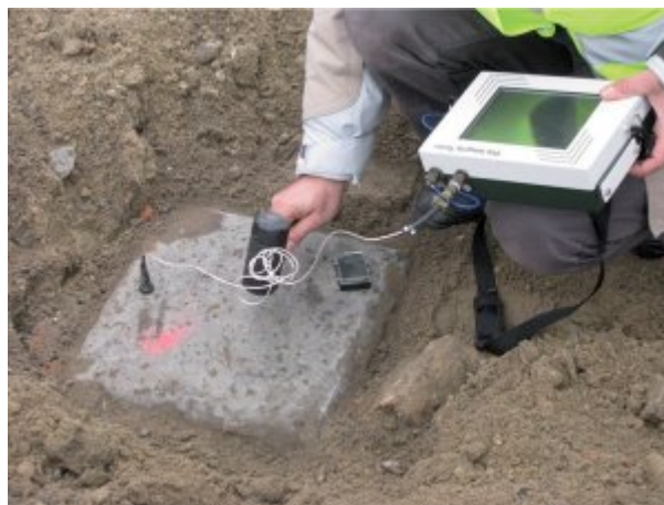
Fot. 9. Urządzenie do badania ciągłości
