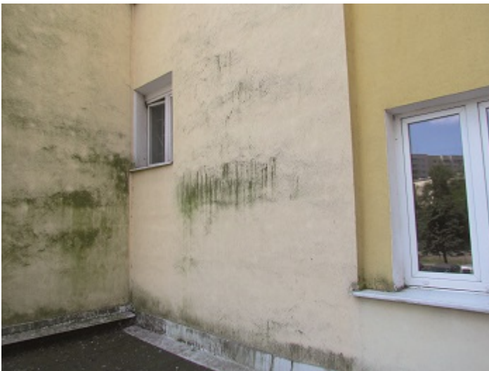
Charakterystyczne porastanie glonami ściany o ograniczonym dostępie słońca i bliskim sąsiedztwie drzew
