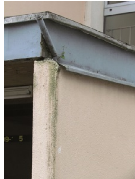
Glony w miejscach utrzymywania się wilgoci od przecieków z nieprawidłowo wykonanych obróbek blacharskich
