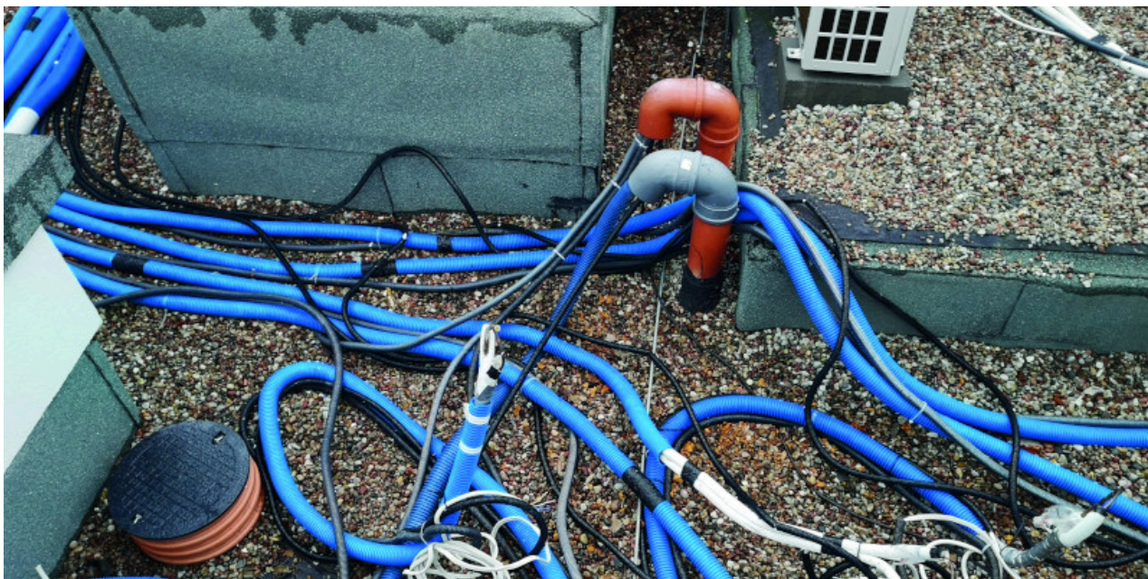
Fot. 3. Skrzynka kontrolna zainstalowana za wysoko, z pokrywą bez perforacji, w niefortunnym otoczeniu plątany przewodów
