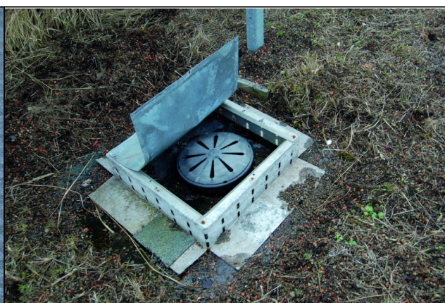
Fot. 5. Skrzynka kontrolna z ulegającej korozji blachy ocynkowanej, z pokrywą bez możliwości wielokrotnego otwierania i zamykania (fot. autora)
