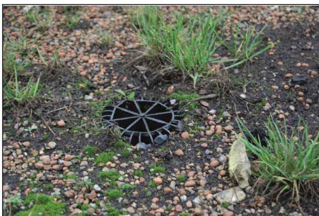
Fot. 1. Brak skrzynki kontrolnej, nad wpustem zainstalowano „przedłużkę zwieńczoną koszyczkiem” (fot. autora)
