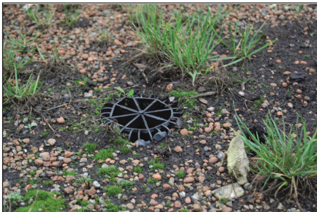
Fot. 1. Brak skrzynki kontrolnej, nad wpustem zainstalowano „przedłużkę zwieńczoną koszyczkiem” (fot. autora)
