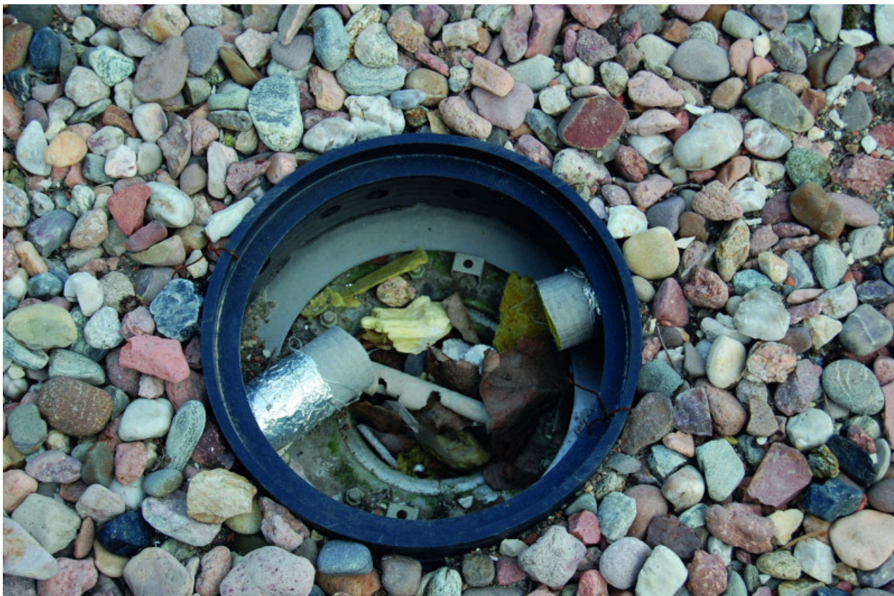
Fot. 6. Skrzynka kontrolna bez pokrywy, która zaginęła w trakcie eksploatacji. Zanieczyszczenia w skrzynce na trwałe uszkodziły kanalizację podciśnieniową (fot. autora)
