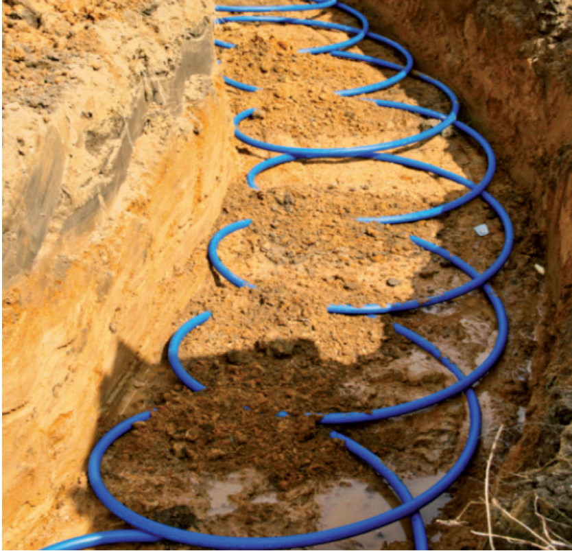
Fot. 5. Glikolowy gruntowy wymiennik ciepła w układzie spiralnym [10]
