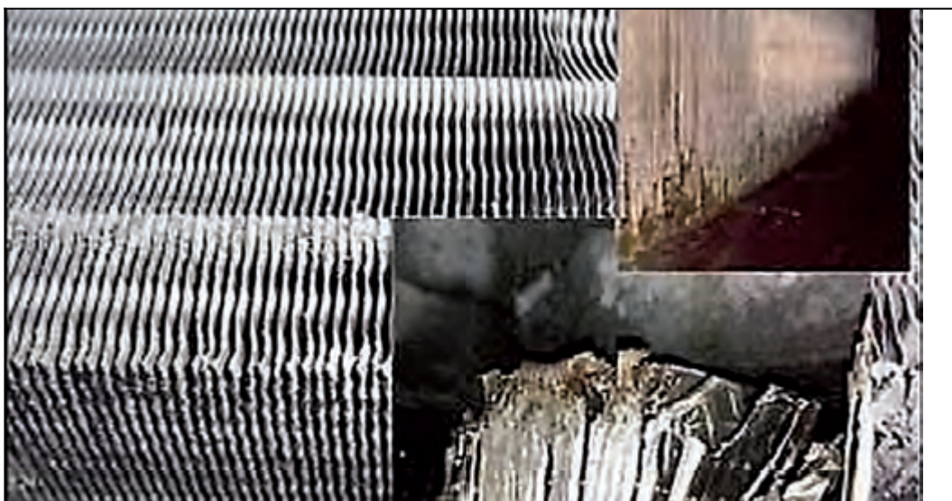
Fot. 1. Skutki działania korozji na elementy instalacji wentylacyjnej basenowej: nagrzewnica i parownik [7]
