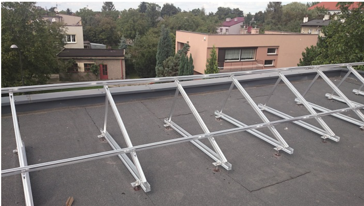
Fot. 4. Konstrukcja montażowa na dach płaski (zdjęcie własne autora)
