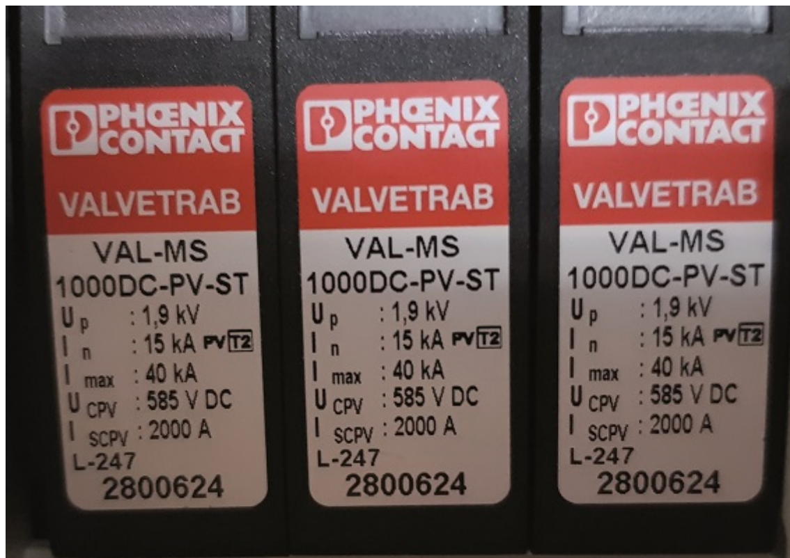
Fot. 9. Zabezpieczenie przeciwprzepięciowe strony DC instalacji PV (zdjęcie własne autora)
