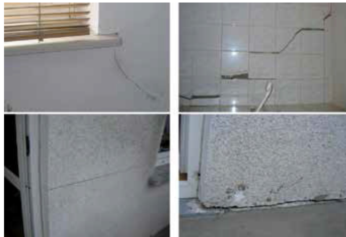
Fot. 1. Zarysowanie ścian działowych i osłonowych wymurowanych
