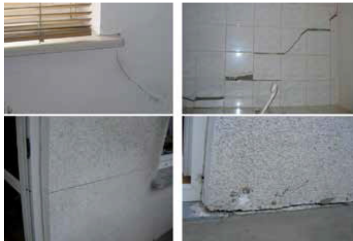
Fot. 1. Zarysowanie ścian działowych i osłonowych wymurowanych
