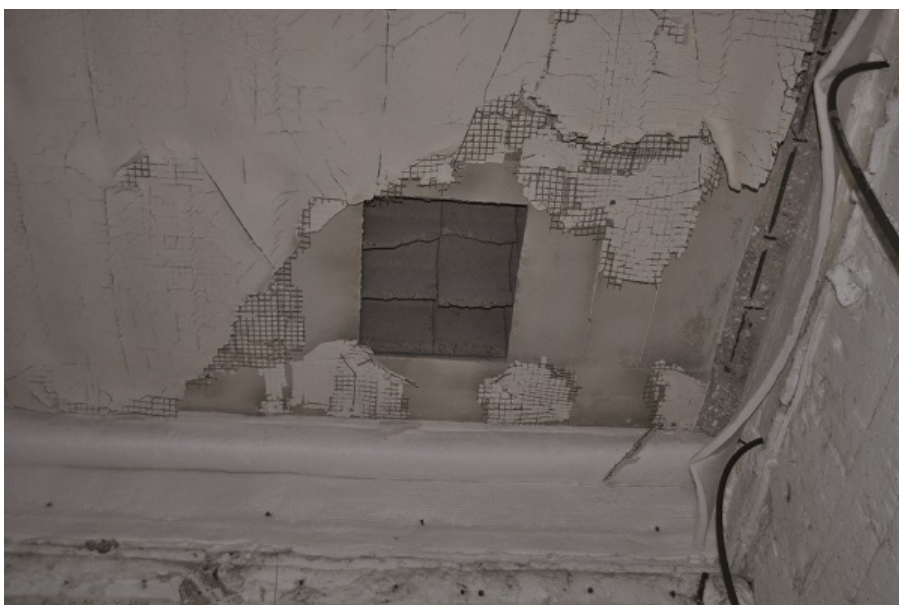
Fot. 1c. Strop jak na fot. 1a po 120 min oddziaływania standardowego. Widok od strony nagrzewanej (od strony pieca). Widoczne odpadnięcie dolnych ścianek pustaków
